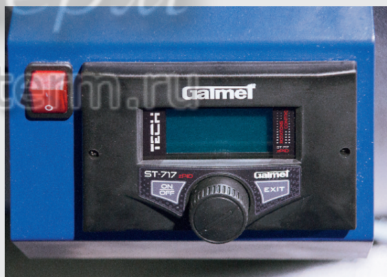
Блок управления факельной горелки
